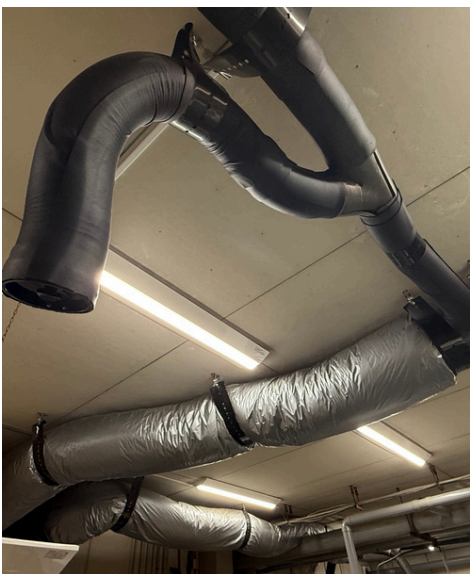
工場の天井にある風送り用ダクト
